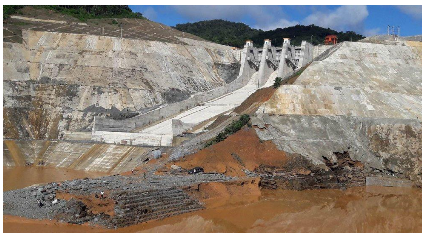
Hình 2 Vỡ thủy điện Sông Bung 2.
