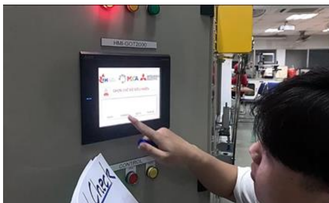
Hình 18. Điều khiển hệ thống thông qua màn hình HMI
