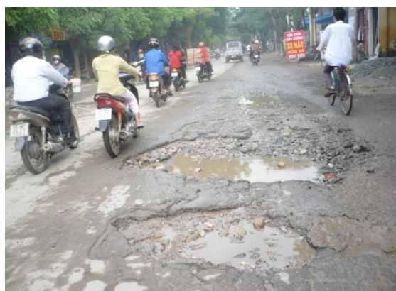
Hình 1: Ổ gà trên mặt đường láng nhựa [3]
