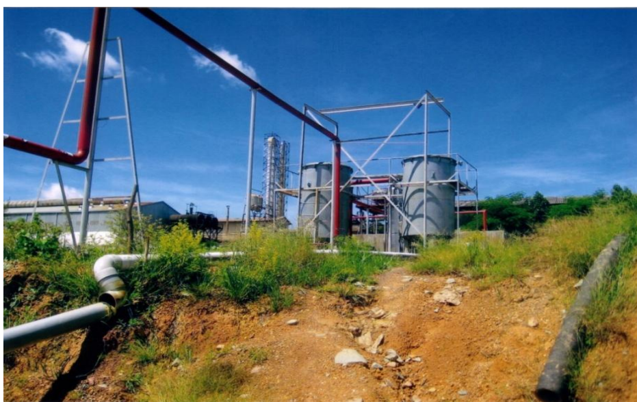
Hình 34: Hệ thống thiết bị xử lý khí biogas tại dự án biogas tại Đắc nông, CS; 60 m3/ngày
